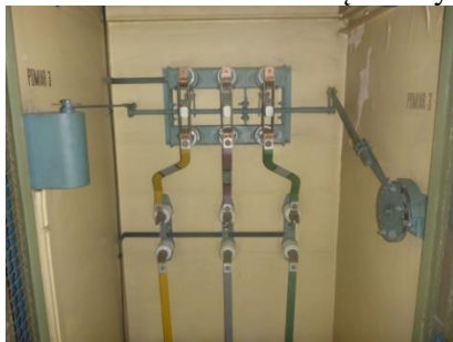
Zdj. 6b. Odłącznik z napędem ręcznym tarczowym zainstalowany w rozdzielni 6 kV na ECI
