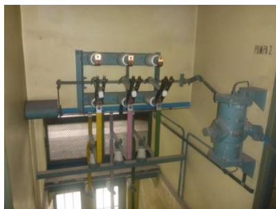
Zdj. 7. Odłącznik z napędem pneumatycznym zainstalowany w rozdzielni 6 kV na ECI
