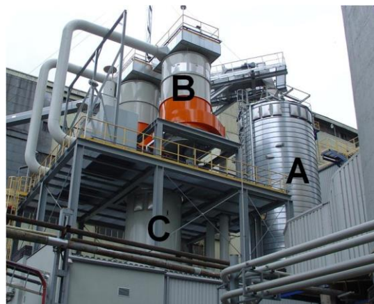
Rys. 1. Stacja przygotowania pyłu biomasowego do bloku BC-1
