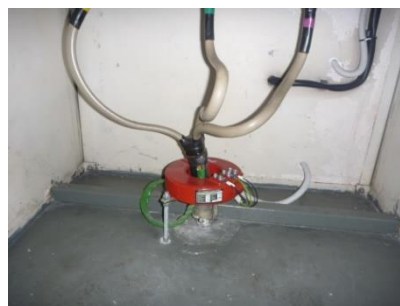
Zdj. 11. Przekładnik ziemnozwarciowy w polu 6 kV rozdzielni RRK typu GIPO na kotłach wodnych (ECII)
