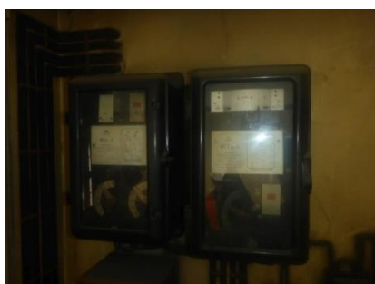
Zdj. 9. Zabezpieczenie przeciążeniowe typu RITs-1 oraz zabezpieczenie zwarciove typu RIo-2 zainstalowane w rozdzielni 6 kV na ECI
