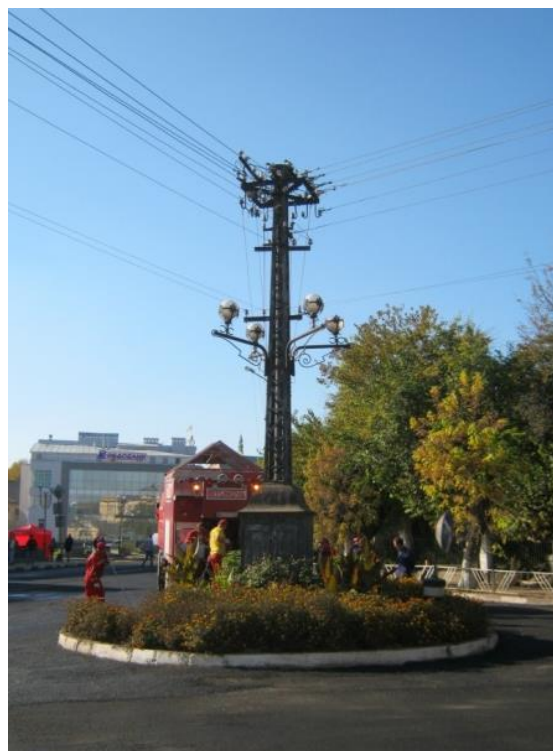
Fot. 13. Słup przedwojennej sieci elektrycznej z lampami oświetlenia publicznego i szafą komutacyjną w Samborze (obecny stan zachowania, źródło: zbiory prywatne autora)
