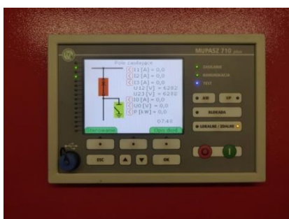
Zdj. 10. Sterownik polowy typu MUPASZ 710 plus w polu 6 kV rozdzielni RP typu PREM-14SM na blokach ciepłowniczych (ECII)
