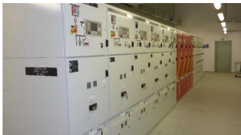
Zdj. 14. Rozdzielnice R1-IMOS i R2-IMOS typu PREM-14SM na IMOS-ie (ECII)
