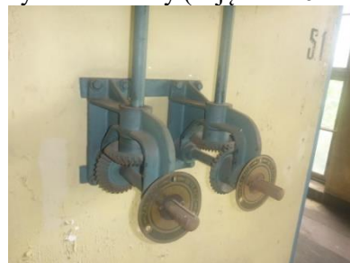
Zdj. 6a. Napędy ręczne korbowe odlączników sekcyjnych zainstalowane w rozdzielni 6 kV na ECI
