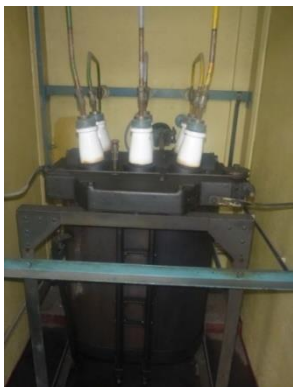
Zdj. 2. Włłącznik pełnoolejowy zainstalowany w rozdzielni 6 kV na ECI
