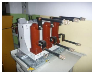
Zdj. 5. Człon ruchomy z wylłącznikiem VD4 wyjęty z przedziału wylłącznikowego rozdzielni 6 kV typu PREM-14SM na wózek manewrowy na blokach ciepłowniczych (ECII)
