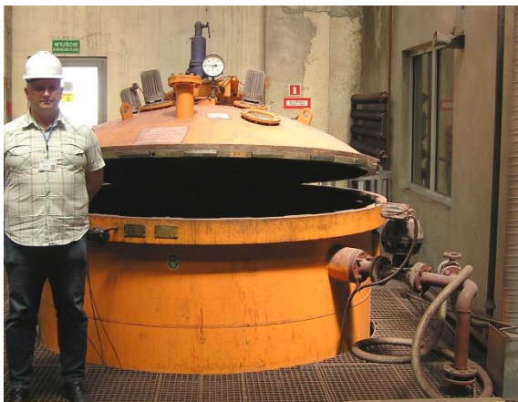
Rys. 8. Stanowisko do nasycania próżniowego elementów maszyn elektrycznych w DFME. Długość zbiornika 6 m, średnica 2,1 m.
