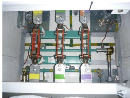
Zdj. 8. Odłącznik szynowy wraz z uziemnikiem zainstalowany w rozdzielni 6 kV RRK typu GIPO na kotłach wodnych (ECII)
