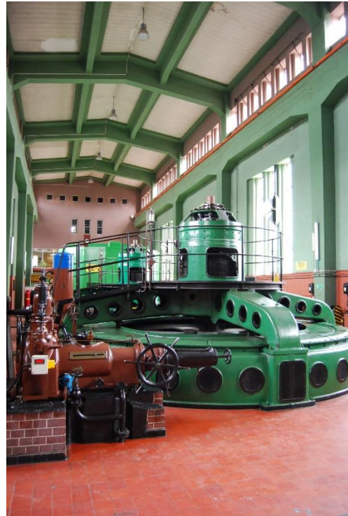
Fot. 4. Widok wnętrza Elektrowni wodnej Wrocław I. Stan z 2013 roku przed modernizacją turbin i generatorów. Fot. P. Gerber 2013 r.
