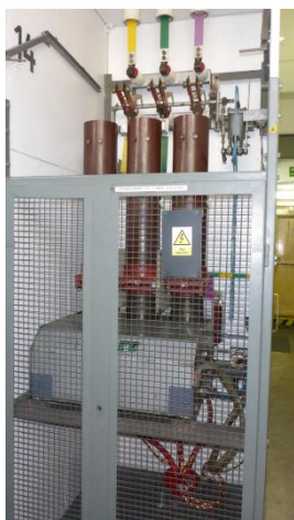
Zdj. 3. Włłącznik małoolejowy zainstalowany w rozdzielni 6 kV RK3 typu GIPO na kotłach wodnych (ECII)
